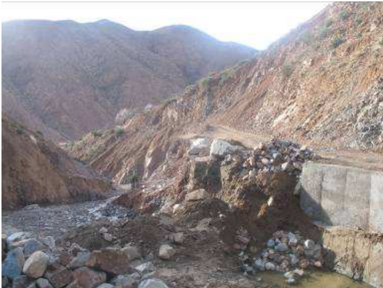
Dégâts causés par une inondation subite.
